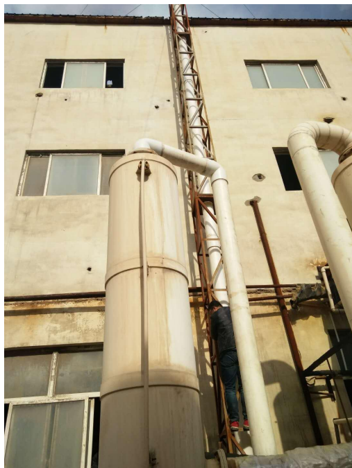
图4-1 二氯频呐酮工段二级碱液吸收塔
