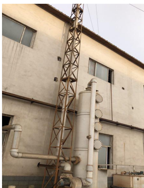
图4-1 硫卡精制工段碱液吸收塔
